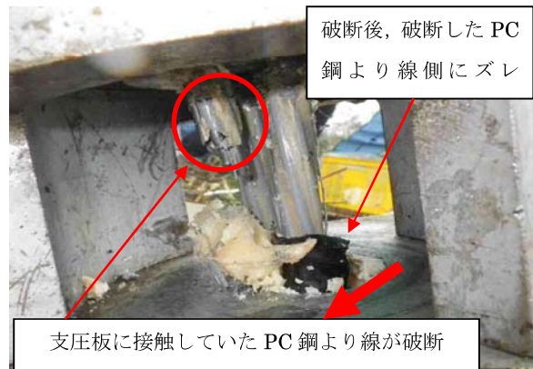
写真 3. 頭部背面のアンカー破断状況
