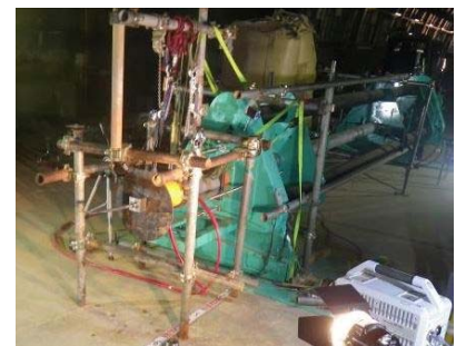
写真-1 アンカー試験装置
