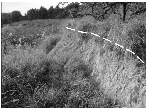
写真2.2 地すべりブロック左側方崖～ 頭部滑落崖(最大高さ1.5～2.8m)
