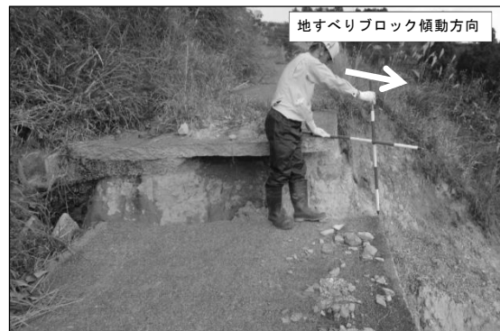
写真2.3 地すべりブロック左側方崖
